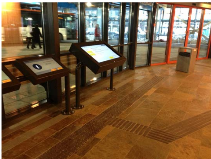
Figur 27: Her er det lagt varselsfelt i stedet for oppmerksomhetsfelt foran billettautomatene – en opplagt feil som burde vært oppdaget og utbedret (foto: Ida Stenbråten Harildstad og Ingrid Øvsteng).
