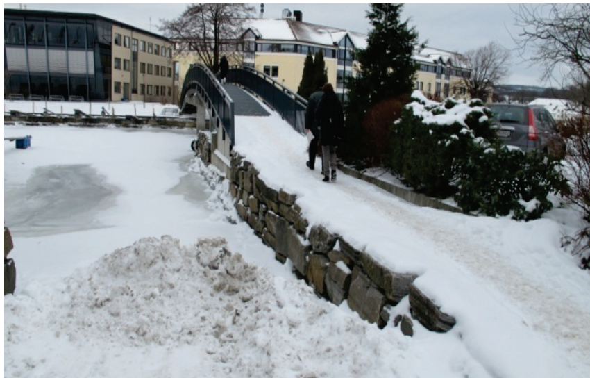
Figur 4.10: Eksempel på gangbru med rekkverk som slutter for tidlig.
