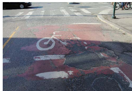
Figur 19. Manglende vedlikehold av sykkelboks i Oslo (Foto: M. Sørensen).
