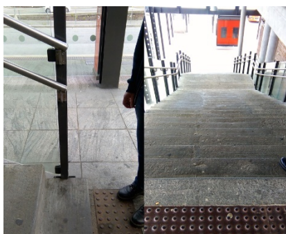
Figur 7: Ingen markering av trappeneser og for kort håndløper på Lagunen
