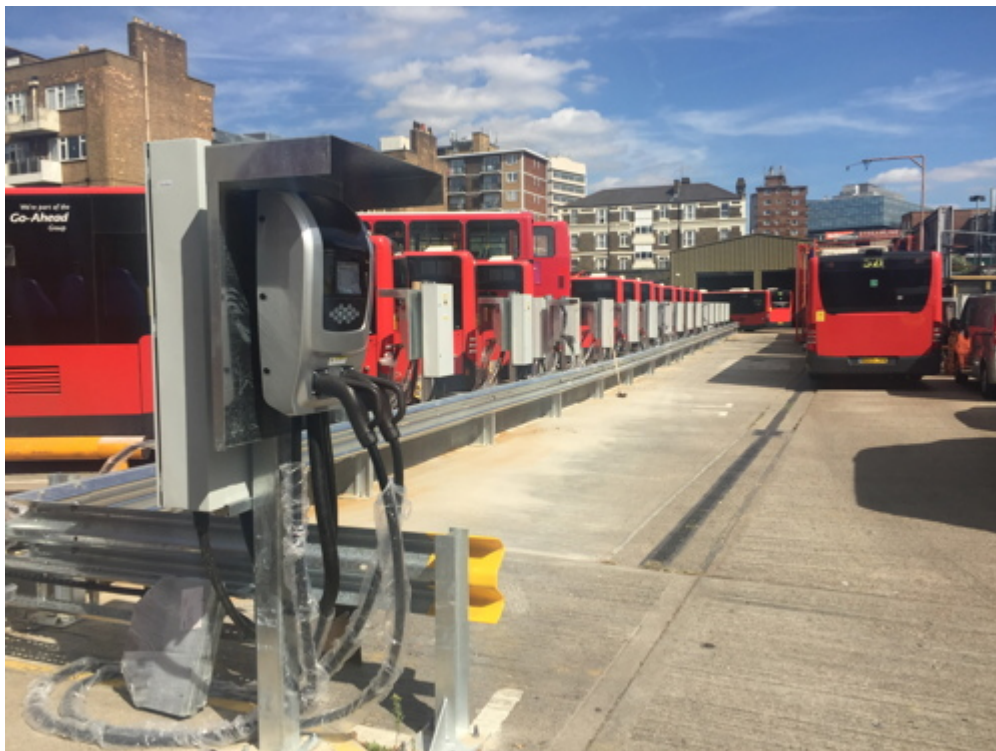
Figur 3.2: Anlegg for depotlading av 46 elbusser ved Waterloo bussdepot i London (Bilde: Zap Map).
