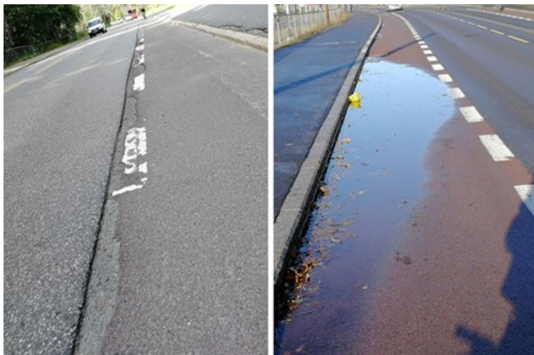
Figur 6: Eksempler på slitt rød asfalt med sprekker og falmet rødfarge, og sykkelfelt i rød asfalt med vannansamlinger.
